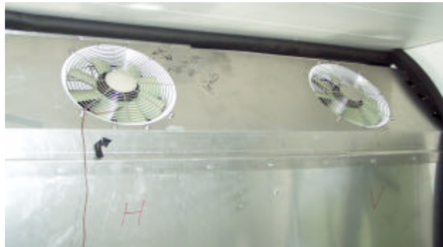
Figur 1: Skråtstillet fordamper (fan coil).
