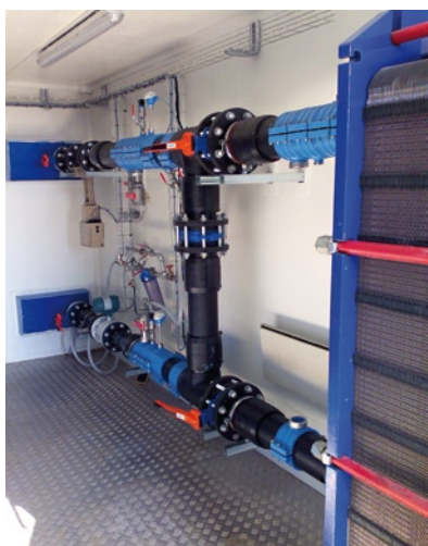
Grundvandet føres i et lukket system frem til varmevekslere, hvor der tappes hhv. kulde og varme til bygningens energiforsyning. Foto: Enopsol.
