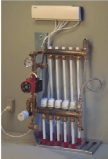
Eksempel på samle- og fordelearrangement til gulvvarmeanlæg. De enkelte gulvvarmesektioner styres individuelt af rumtermostater og elektroniske ventiler.
