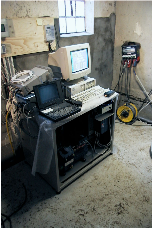
Varmepumpeinstallation – udstyret oven på varmepumpen er del af feltmåleudstyret.
