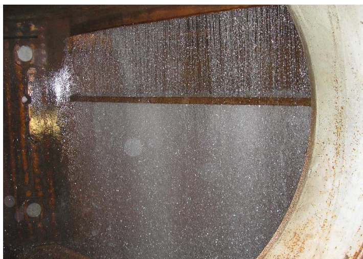
Figur 32 Vandfordeling ved hjælp af perforeret plade i toppen af fordamperen, chillerdrift.
