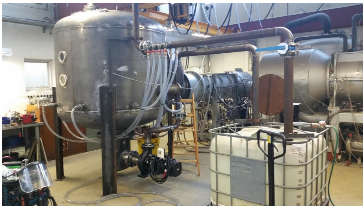
Figur 29 Den færdige installation af fordamper og reservoir med forbindelser til både toppen af beholderen, til spraypladerne og til de seks dyser i bunden af beholderen. Ventileregulerer manuelt, hvor stor en brøkdel der ledes til hver del.
