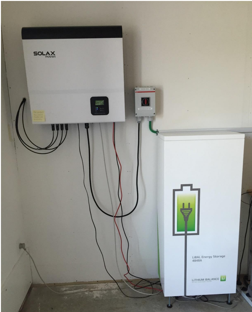
Figur 29 Solax inverter med batterisystem leveret af Lithium Balance
