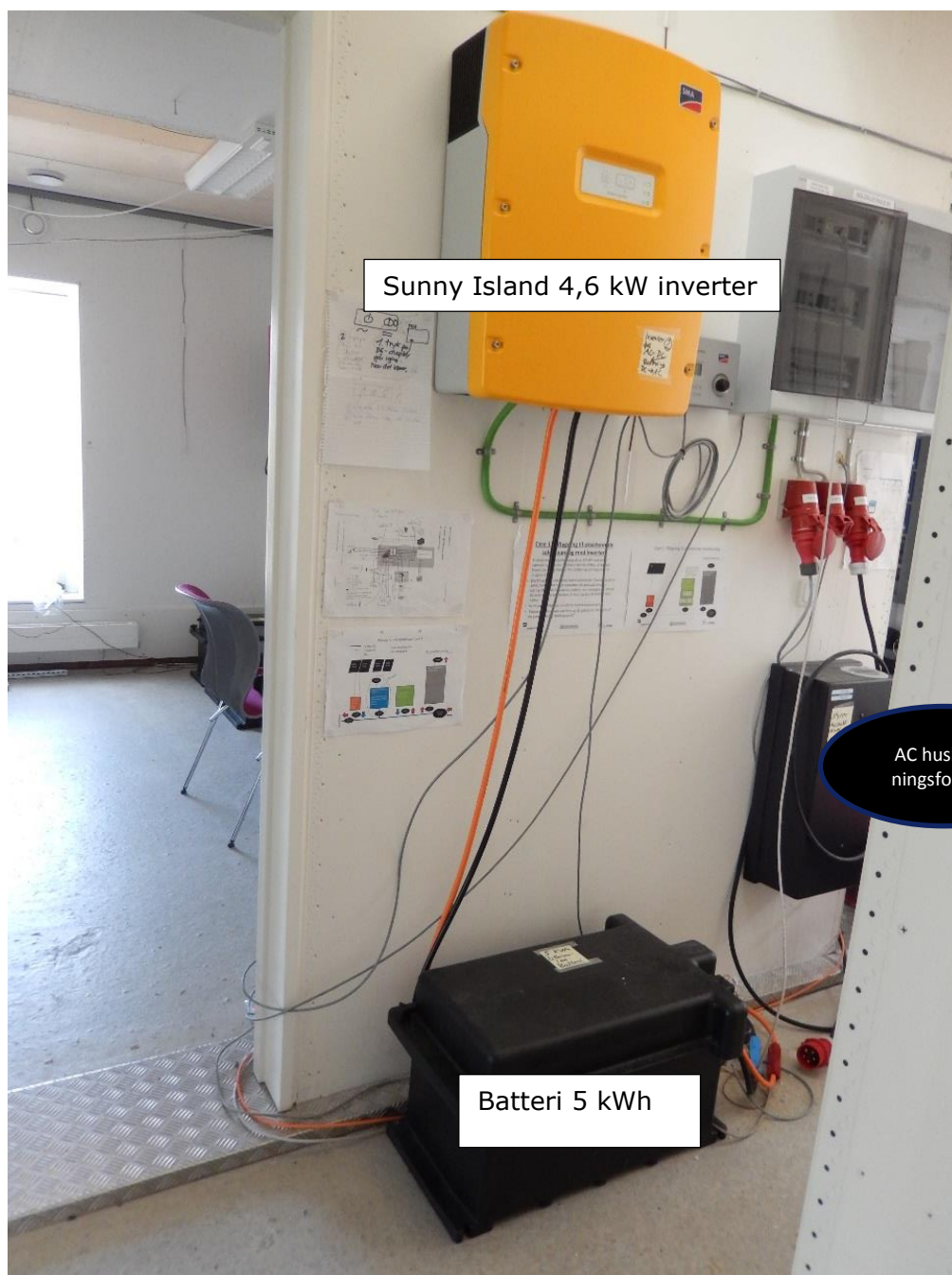
Figur 15 Batteri og Sunny Island inverter monteret
