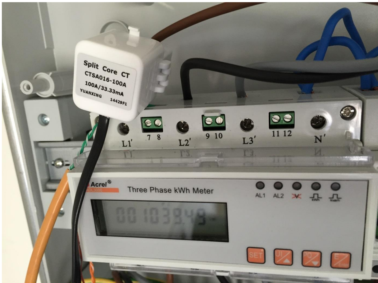
Figur 30 Solax-inverteren måler om der er import eller eksport af strøm på sin egen faseledning via en lille strømsensor, som clipses fast om lederen ved hovedmåleren
