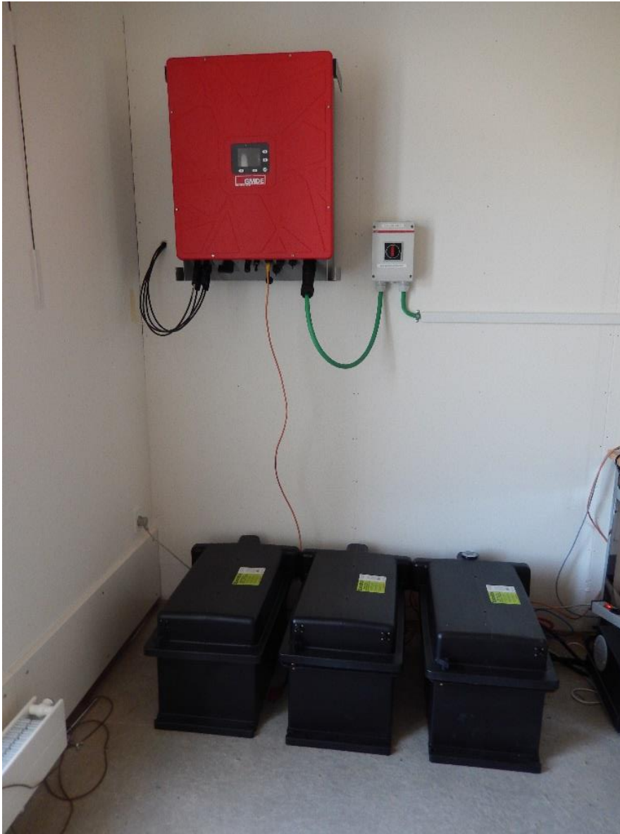
Figur 28 GMDE inverter med batteri på 10 kWh. Kom desværre aldrig til at køre!
