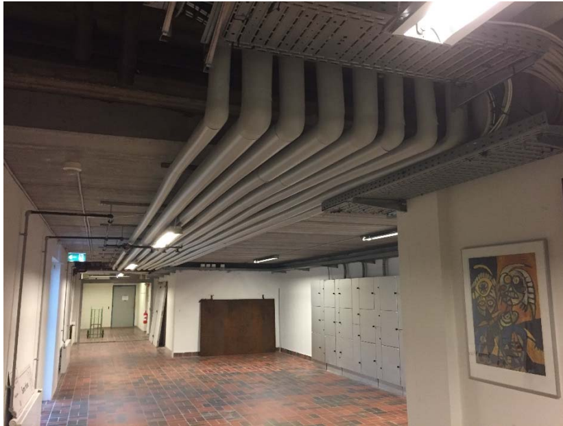
Figur 4.1: Brugsvands- og rumopvarmningsrør under lofter i mellemgangen mellem Blok A og B.
