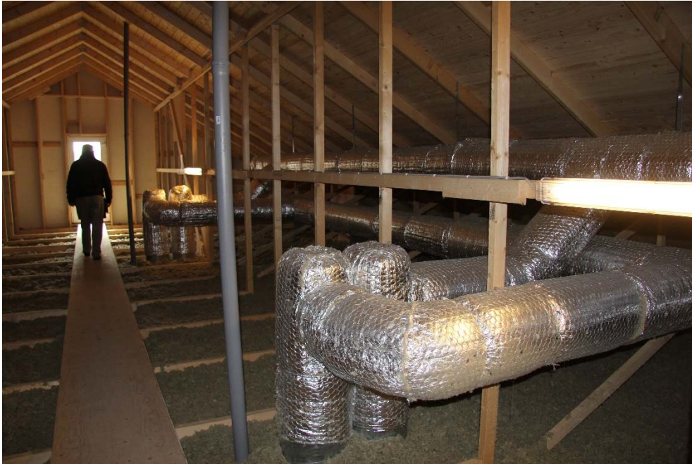
Figur 3.6: Loftet i Blok B. Billedet viser isoleringsmaterialet samt de isolerede ventilationskanaler.
