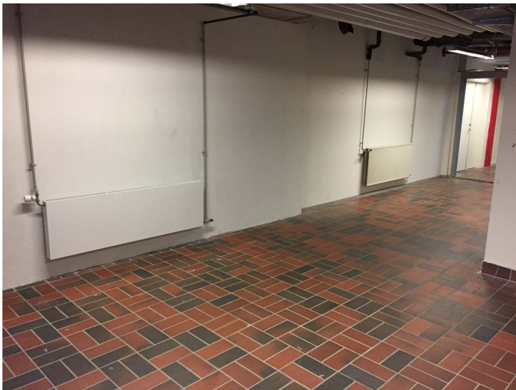
Figur 3.20: To af de tre radiatorer i mellemgangen.
