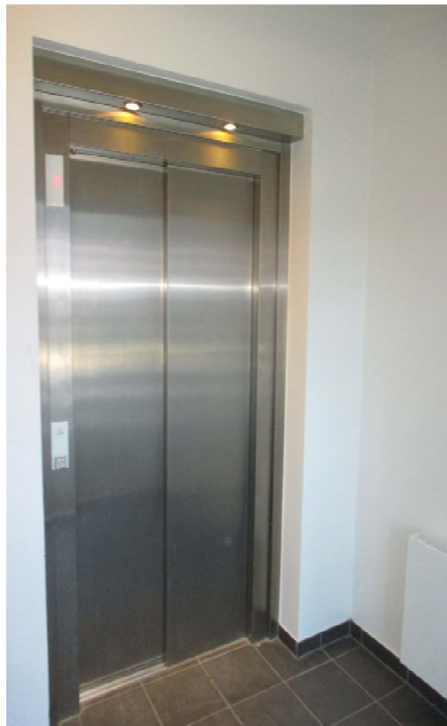
Figur 4.5: LED spot over dørene til elevatorerne.
