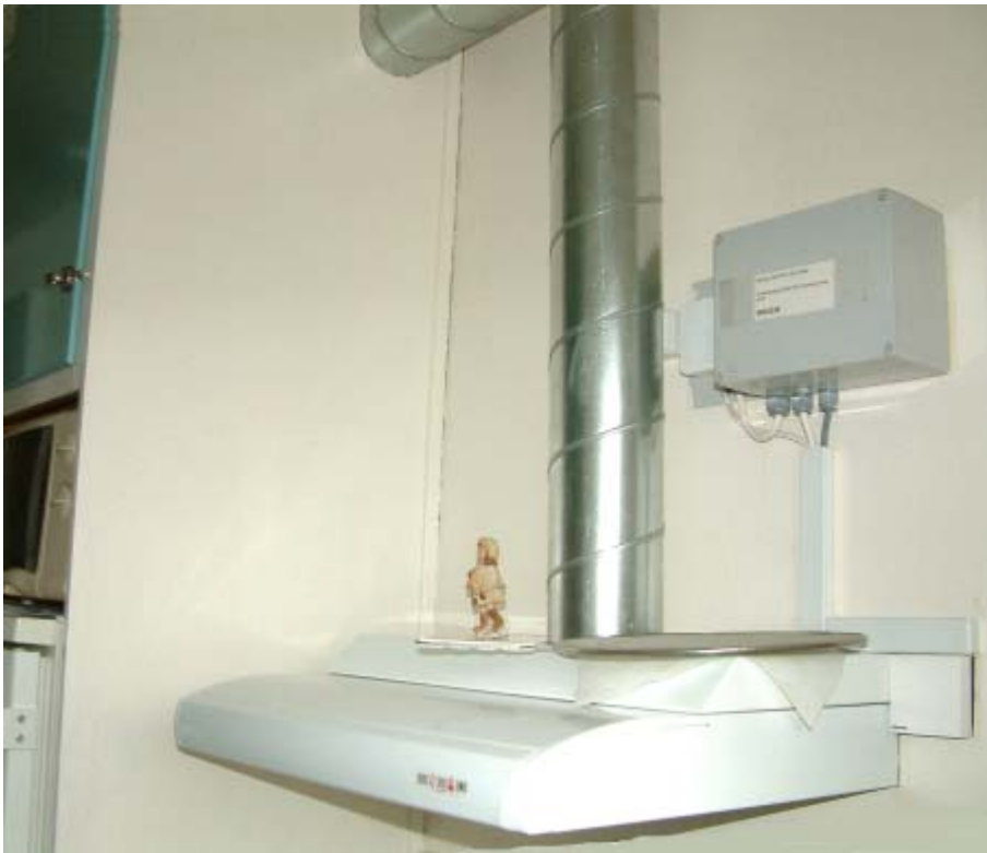
Figur 10. Emhætte fabrikat Exhausto type ESL 130 WE og hygrostat i lejlighed med behovstyret ventilation.
