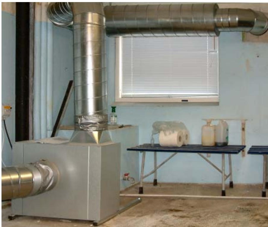
Figur 2. Den ene af udsugningsanlæggene anbragt i den nederste etage og med afkastet ført gennem ydervæggen i gadeniveau.
