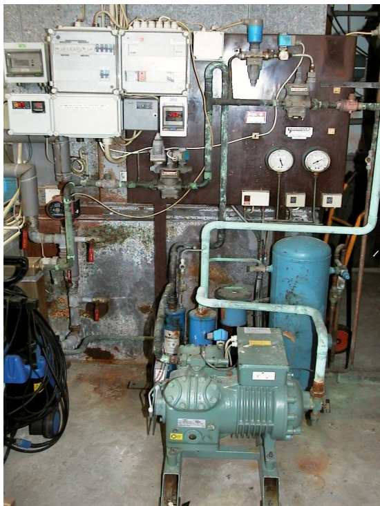
Varmepumpen - kompressor: Bitzer 4P-15.2Y med kølemiddel: R407C
