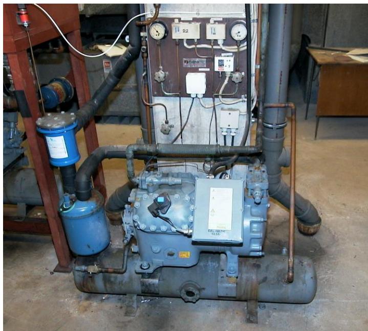
Figur 2: Anlæg til opvarmning af ventilationsluft
