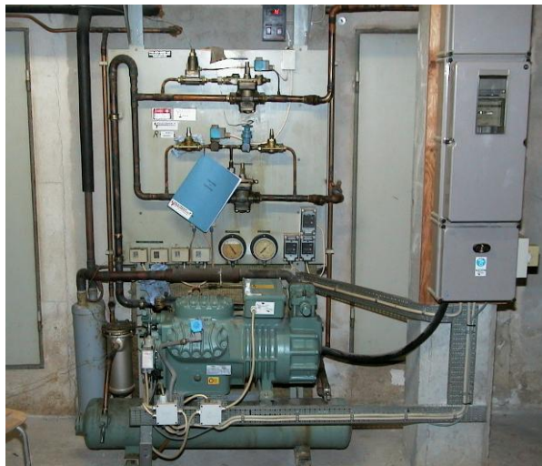
Varmepumpen - kompressor: Bitzer 6H-35.2Y med kølemiddel: R407C
