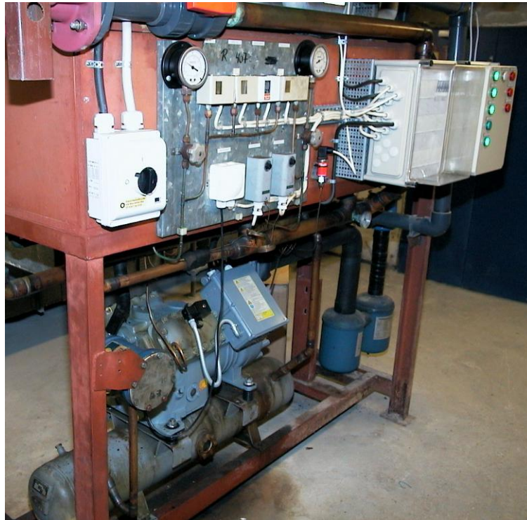
Figur 2: Anlæg til opvarmning af brugsvand
