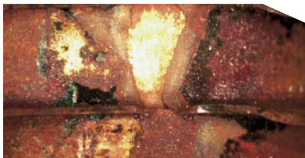
Den ubehandlede veksler udviste kraftig korrosion efter testen hos Vestas AirCoil.
