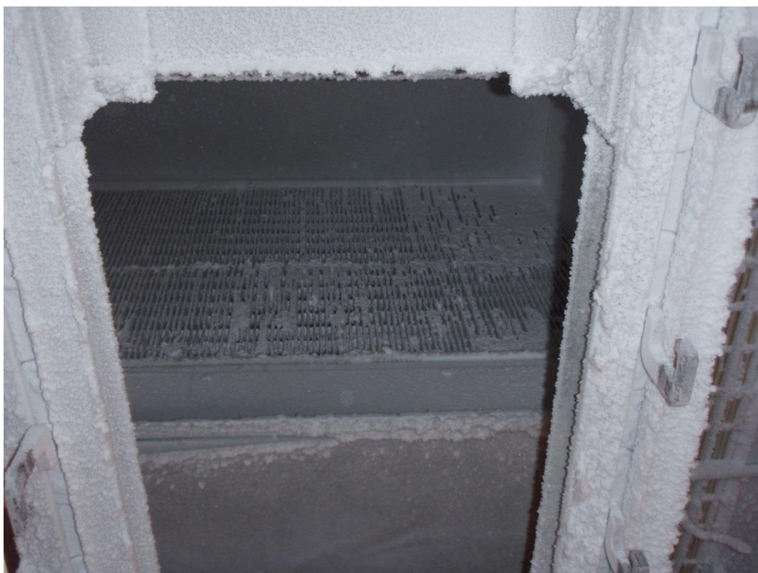
Billede 6: Køleflade fotograferet fra gulvet. Kølefladen sidder 3-4 m oppe under loftet over forskellige ståldragere, som bærer den conveyor, der fører de slagtede svinekroppe igennem tunnelen.
