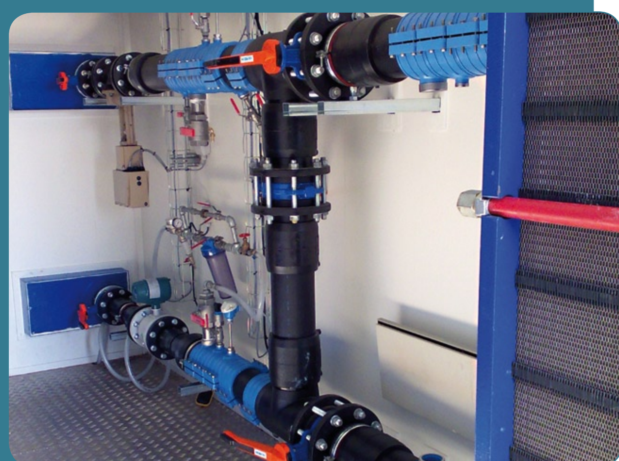
Grundvandet føres i et lukket system frem til varmevekslere, hvor der tages hhv. kulde og varme til bygningsenergiforsyning. Foto: Enopsol.
