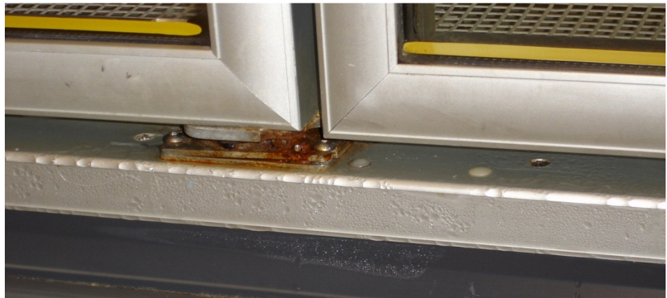
Figur 22: Ved 23 °C og 50% relativ fugtighed er der efter nattens løb kondensat på hele listen under lågerne.
