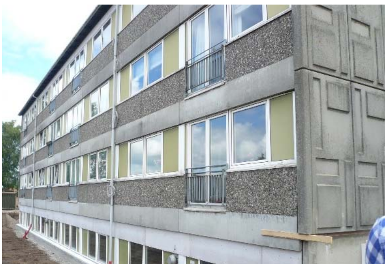
Figur 1. Boligblok med nedslidte facader før renovering.
