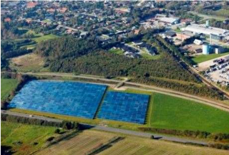
Figur 7. Solfangeranlæg tilsluttet Oksbøl Varmeværk, placeret øverst til højre.
