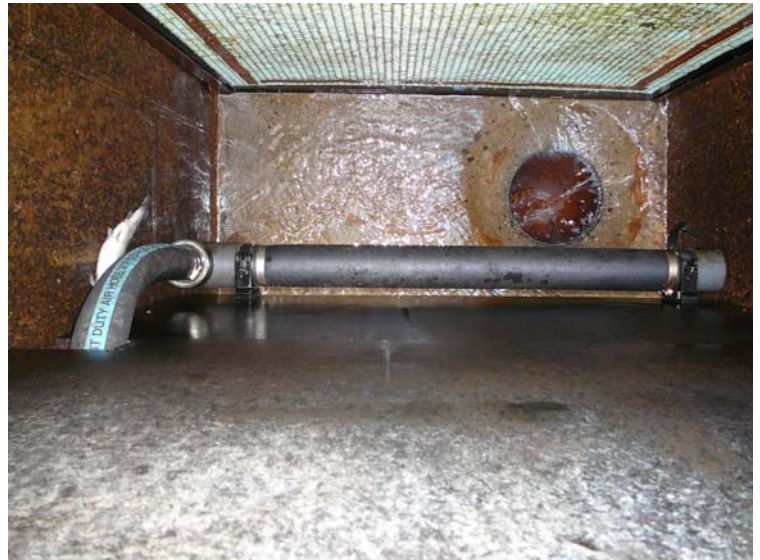
Figur 29 Eksisterende kummediffusor på Abildvad dambrug
