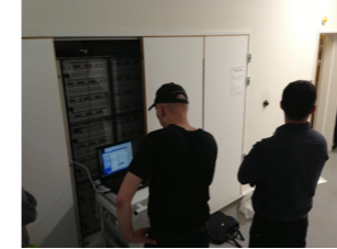
Programmet for den dynamiske dagslysstyring tilkobles de 8 belysningsarmaturer på akutafsittet på Slagelse Sygehus. Jakob Holmstrøm Jensen, LEDLIGHT Components Aps og Jakob Markvart SBI.
