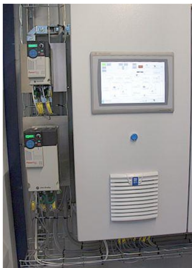
Figur 10d. Varmepumpeopstillingen, styretavle.
