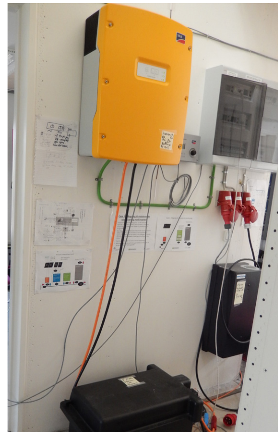
Figur 2. Forsøgsopstilling med lithium-ion batteri og SMA-inverter.
