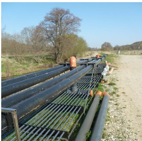
Figur 5: Lavtryksdiffusorerne – på land, før de blev installeret
