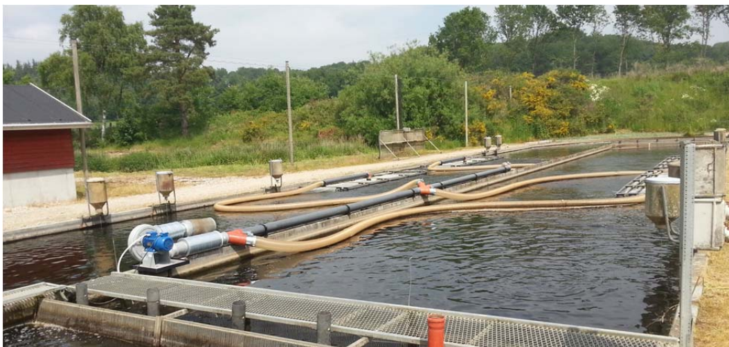
Figur 4: Lavtryksdiffusorer til afgangning af CO 2 ved hjælp af indblæsning med luft fra lavtryksblæsere.
