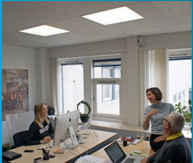
DayLight armaturer installeret i kontormiljø på GlobalConnect, hvor de supplerer dagslyset og giver et mere spændende arbejdsklima.
