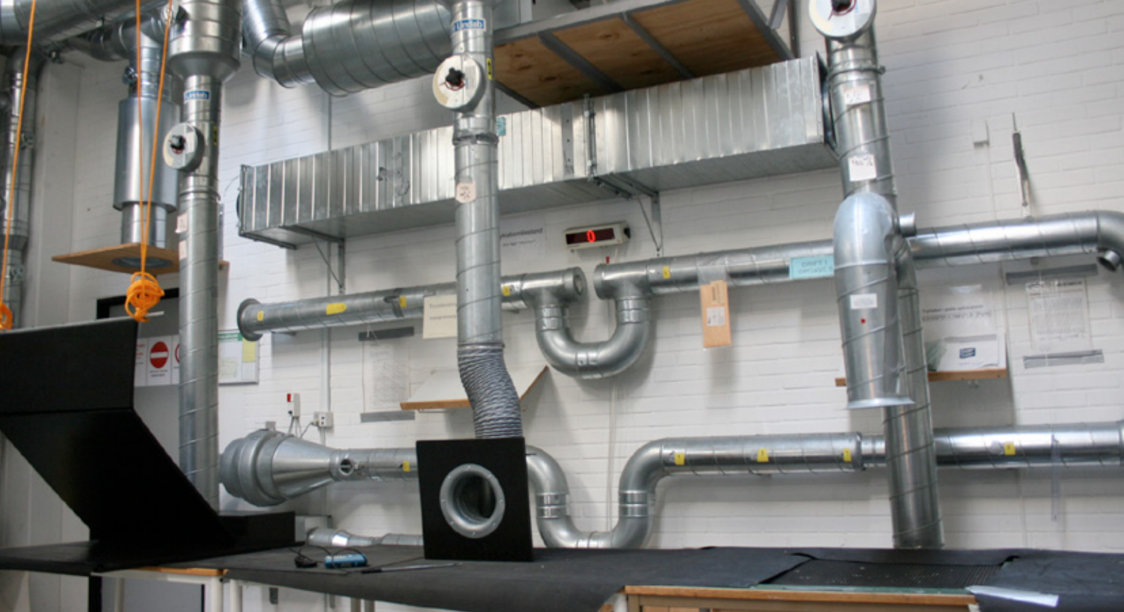
Testopstilling på tre forskellige udsugningsløsninger.
