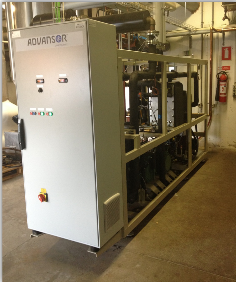
Figur 20: foto af CO 2 varmepumpe ved Jensen Køkken
