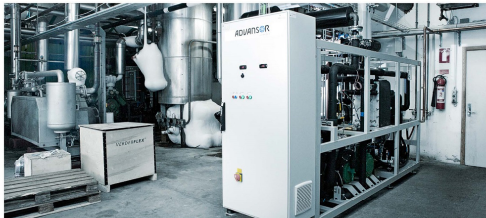
Varmegenvindingsanlæg ved kølekompressor hos Jensen's Køkken. Varme fra kølekompressorer overføres i løbet af dagen til tanken med varmt vand til rengøring.
