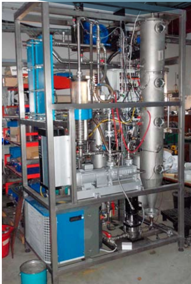
Et forsøgsanlæg med en varmepumpe baseret på vanddampkompression på Teknologisk Institut gik forud for den egentlige demonstrationsdrift hos Haldor Topsøe A/S.
