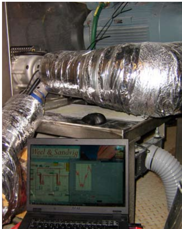
Der måles på anlægget hos Haldor Topsøe A/S for at kunne beregne hastigheden på kompressorhjul, gearaksel m.v. og på det grundlag bestemme kompressorens og friktionsgearets ydelse.
