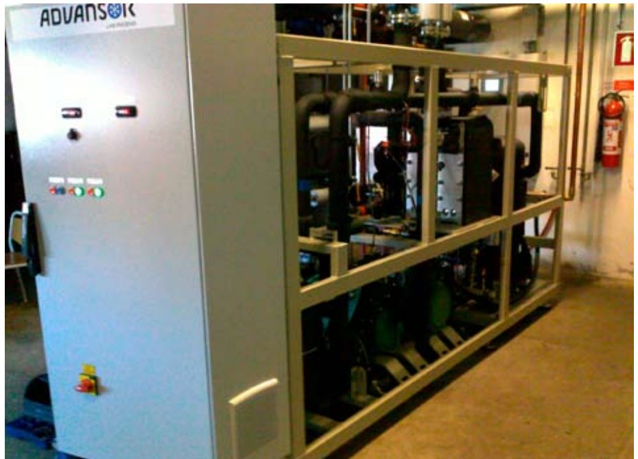
Med et CO 2 -kritisk varmepumpeanlæg kan overskudsvarme fra et ammoniakkeleeanlæg opgraderes til en temperatur, der kan udnyttes i den hygiejnisk krævende rengøring hos Jensen Foods.
