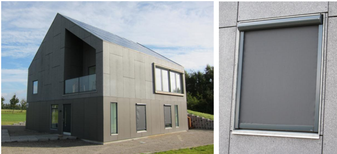
Figur 6: Solafskærmning i EFH, tv.: solafskærmning på sydsiden, th.: solafskærmning på østvinduer
