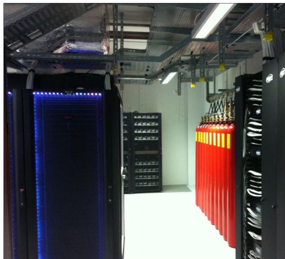
Billede 2: Serverrum, til venstre ses serverrack, i baggrunden UPS anlæg og til højre brandslukningsanlæg.
