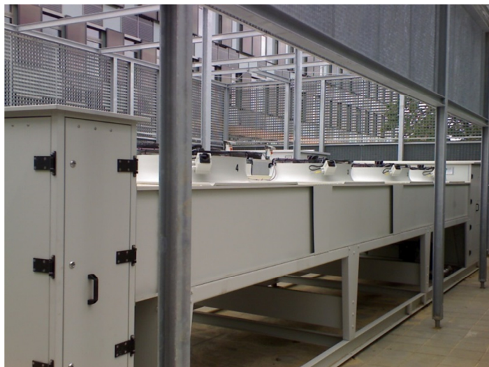
Billede 3: Teknikgård med køleanlæg, i baggrunden administrationsbygningen.
