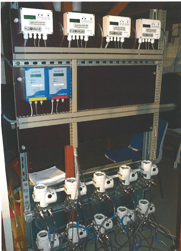
Billedet viser noget af det omfattende måleudstyr. Her ses 14 trykmålere, 2 fugtighedsmålere, 4 spjældregulatorer, her til kommer et barometer, ca. 40 temperatursensorer, 3 elmålere og 1 affugter. Alle målere har forbindelse til LabView programmet.
