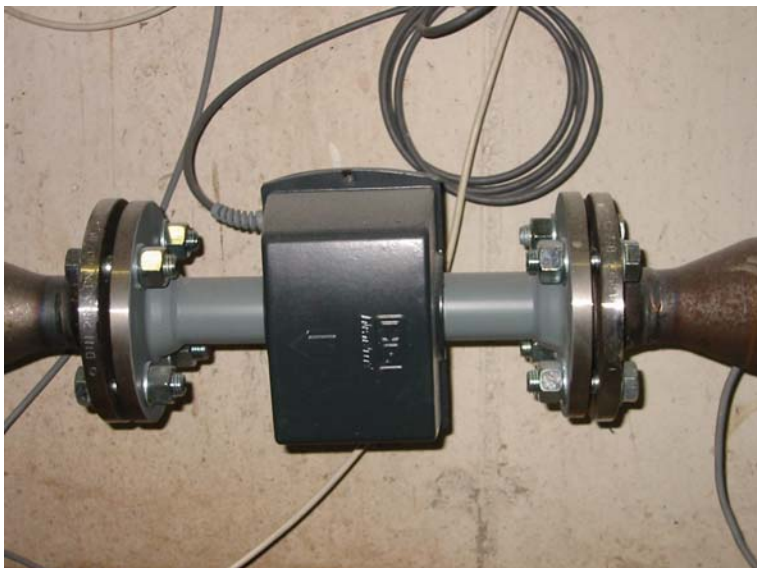
Figur 2. Brunata flowmåler monteret på centralvarmeanlægget i Charlotteager, Hedehusene.
