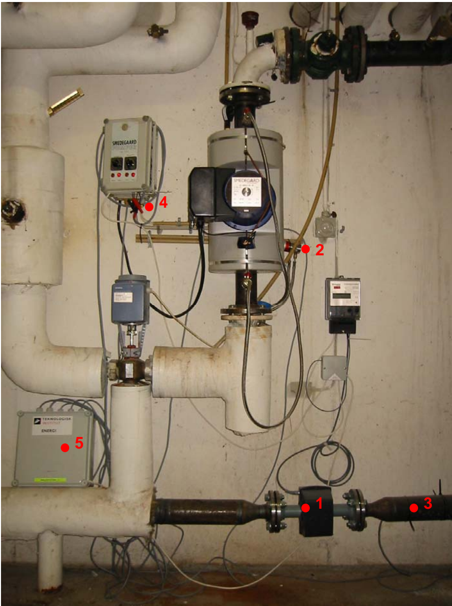
Figur 1. Måleudstyr monteret på centralvarmeanlægget i Charlotteager, Hedehusene.
