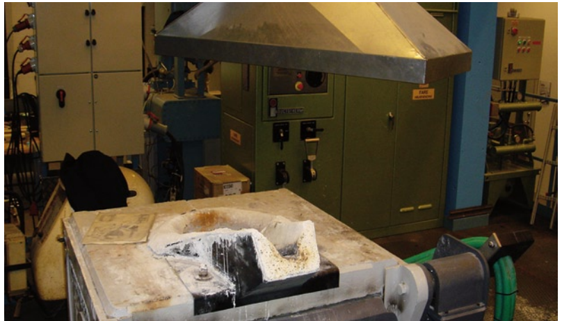
Beregnet udsug over aluminiumssmelteovn.
