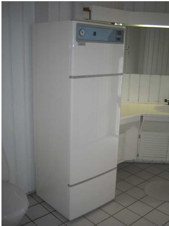
Figur 58 Ny varmtvandsbeholder med styringsautomatik for VP, Knebel
