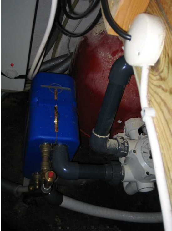
Figur 52 Varmevexsler for poolopvarmning Øer, Ebeltoft
