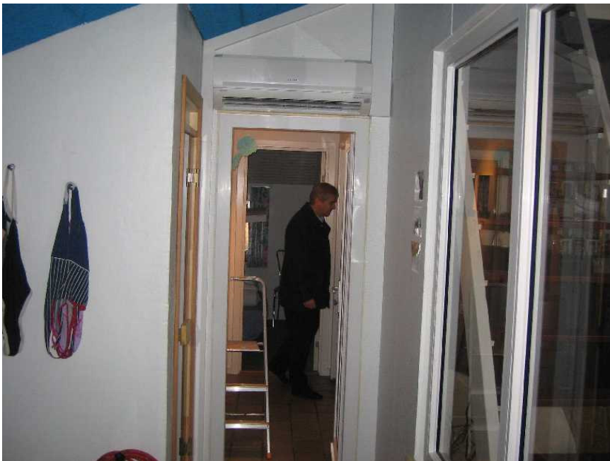
Figur 53 Opvarmningsdel for rumvarme i pool placeret over dør, Øer Ebeltoft
