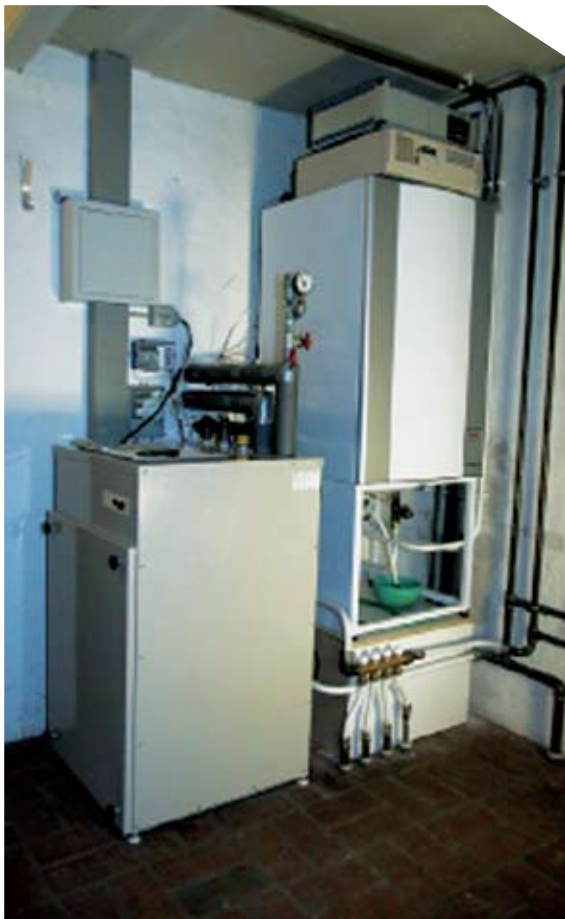
Jordvarmepumpe med frekvensreguleret kompressor. Desuden ses den separate varmtvandsbeholder.
