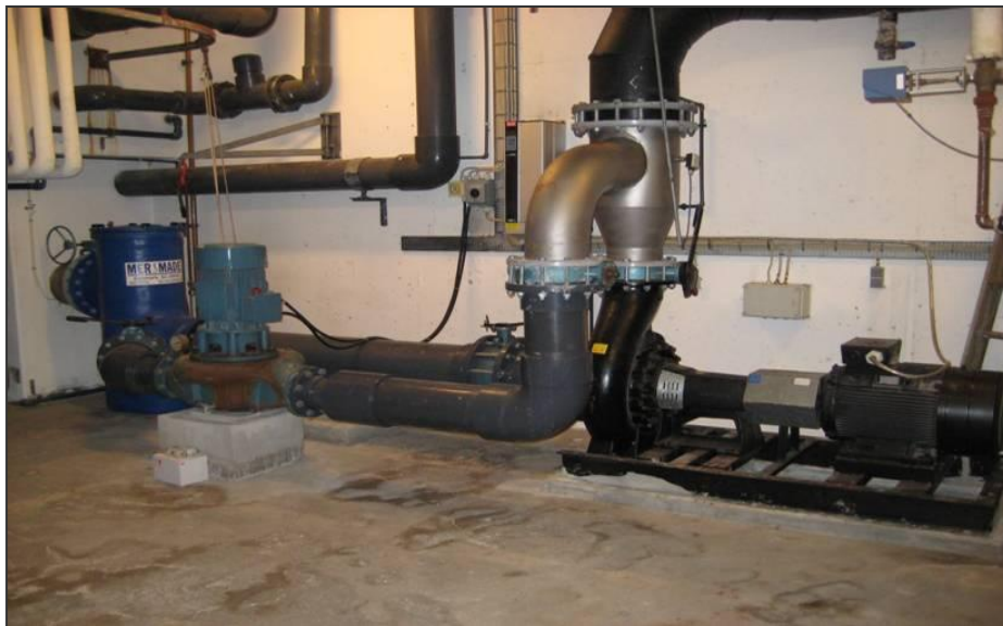
Figur 3 Nyt filter (tv.) og ny blokpumpe til 50 m bassin. En af de gamle pumper kan indkobles manuelt som reserve.
