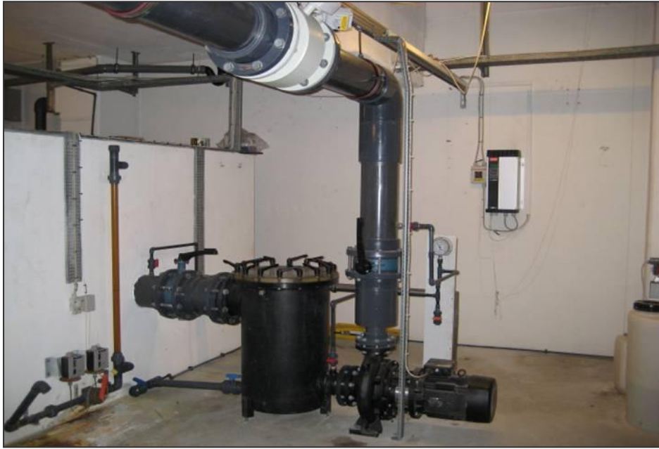
Figur 4 Ny pumpe til varmtvandsbassin i stedet for in-line pumpe og bøjning
