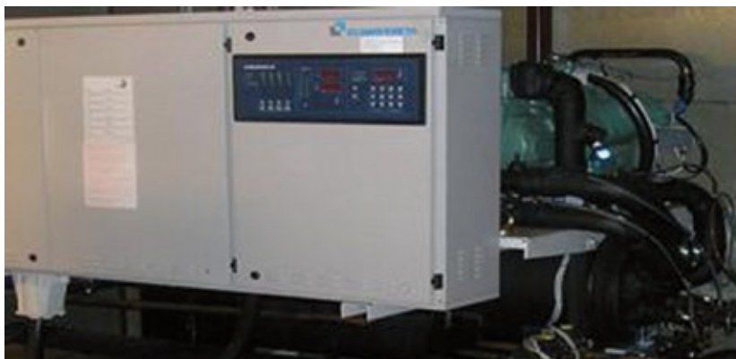
Jordvarmepumpe til opvarmning af både bassinvand, brugsvand og ventilationsluft
