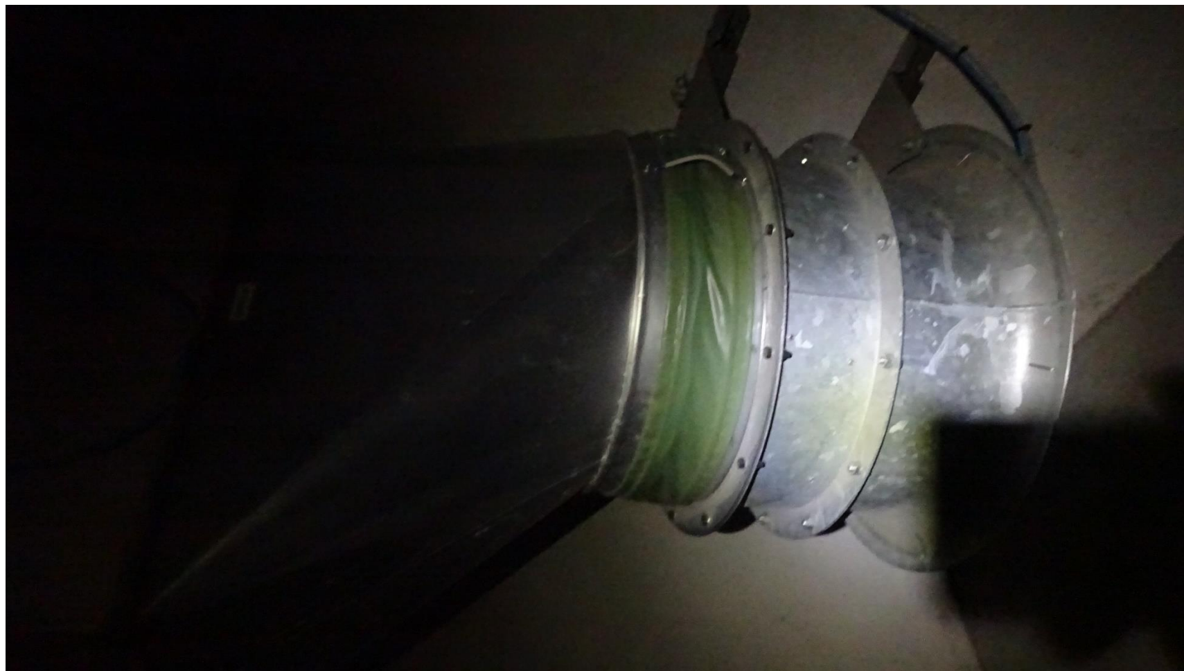
Udsugningsventilator, Novenco axial i fælles sugekammer. Intet lys.
