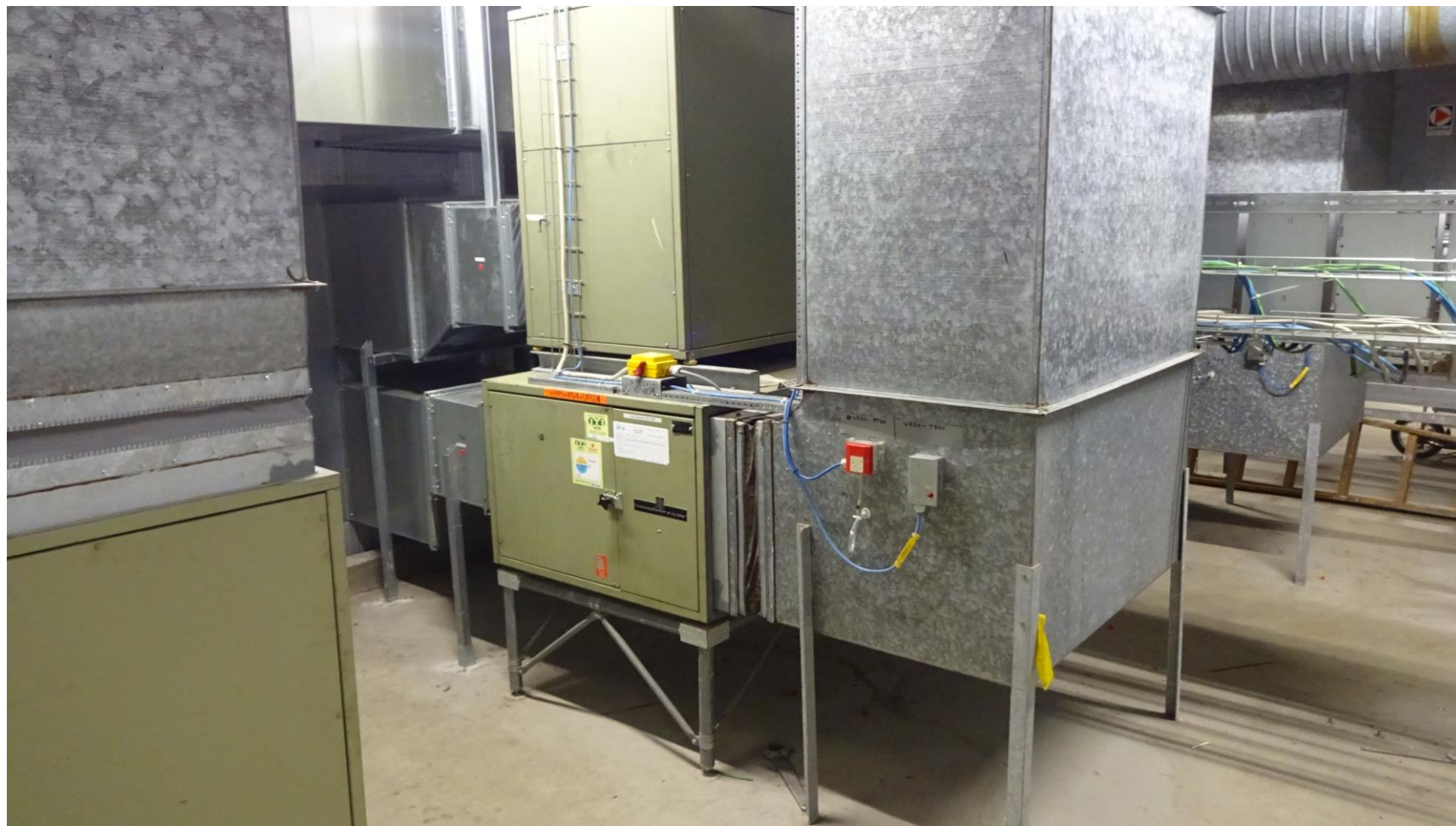
Udsugningsventilator før hovedanlæg
