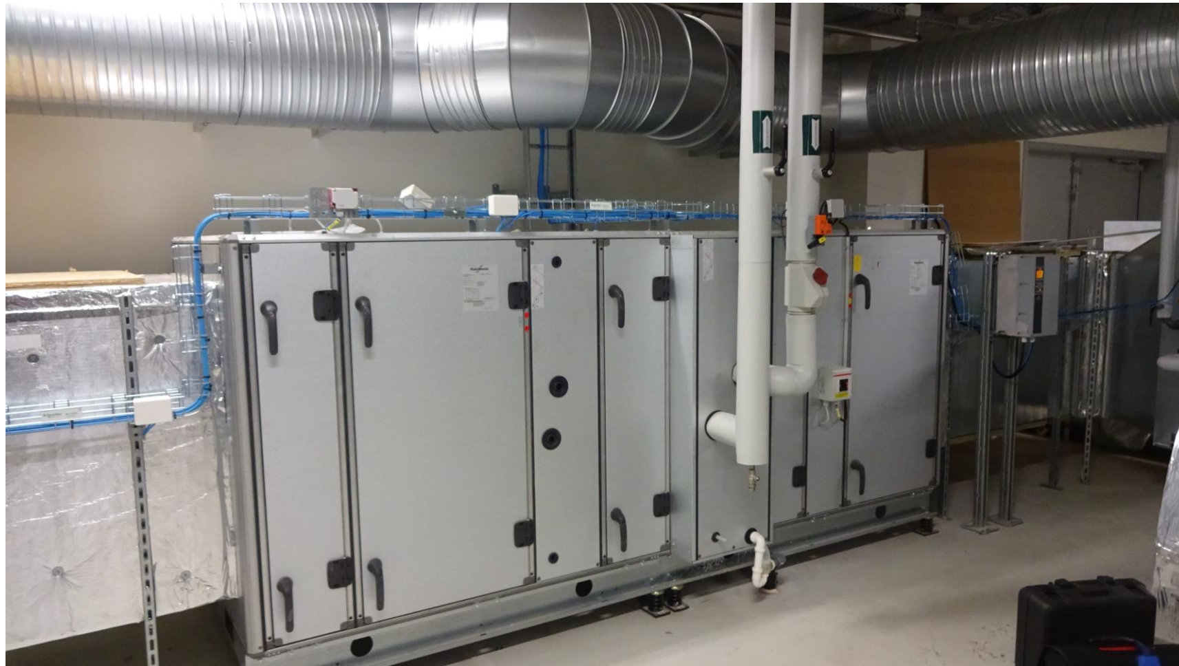
LAF unit i teknikrum
