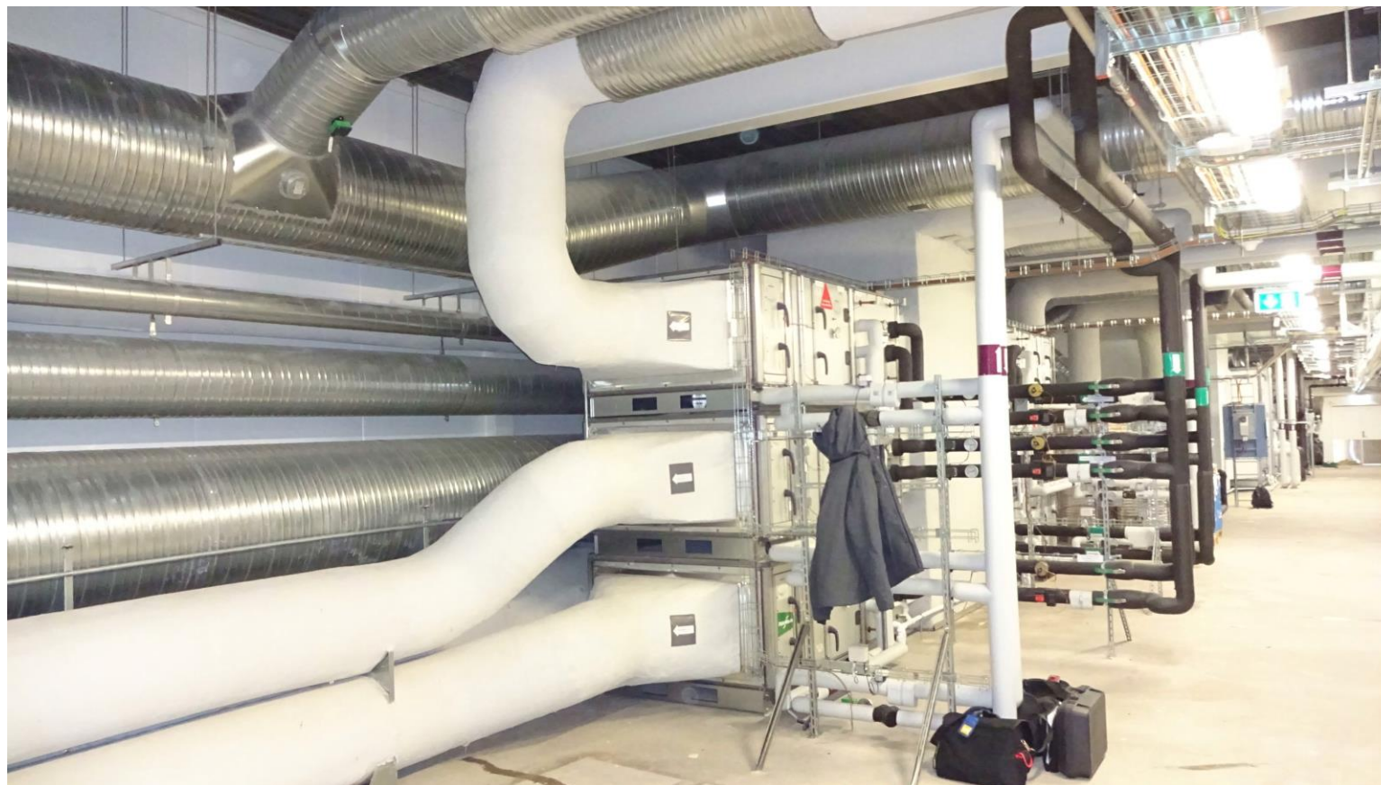
HEPA filterunits klynge for 3 op-stuer. Forsynes fra 2 ventilationsanlæg for 80 % redundans
