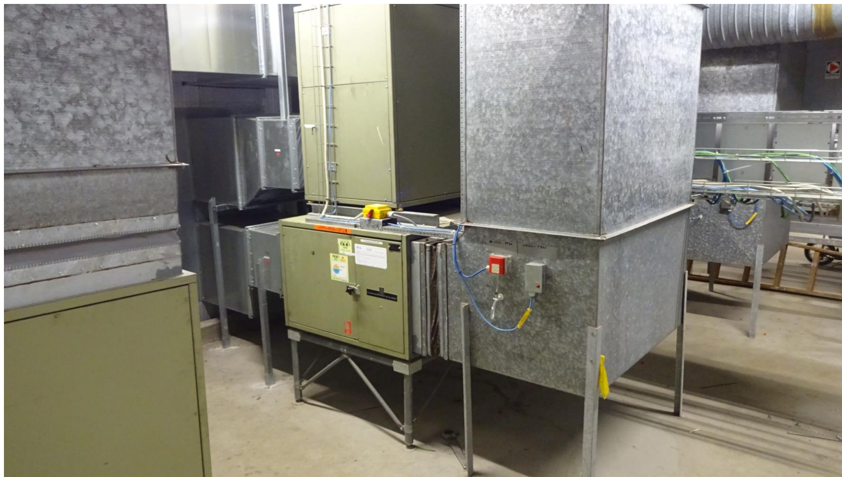
Udsugningsventilator før hovedanlæg
