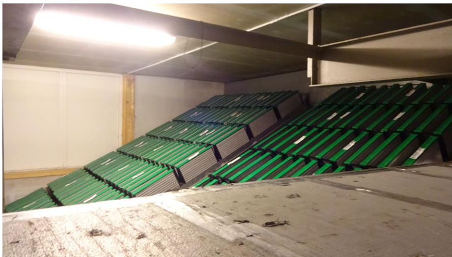
Indtagsskammer med koblede batterier
