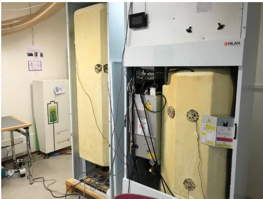
Figur 16 Installationen med buffertank til venstre og varmepumpeunit med varmtvandsbeholder til højre
