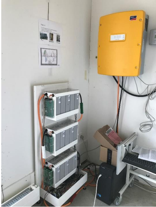
Figur 12 Batteri og inverter/lader. Printkortene på siden er dele af batteriets BMS system.
