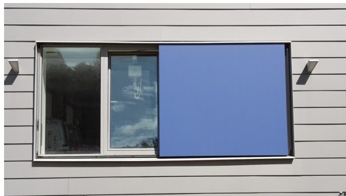
Figur 21. Rammesystem med blå screendug på pavillonbygningen på Rigshospitalet. Den hvide type screendug fungerede dårligt og blev udskiftet med en blå på syd- og vestvendte facader. Foto: Art Andersen.
