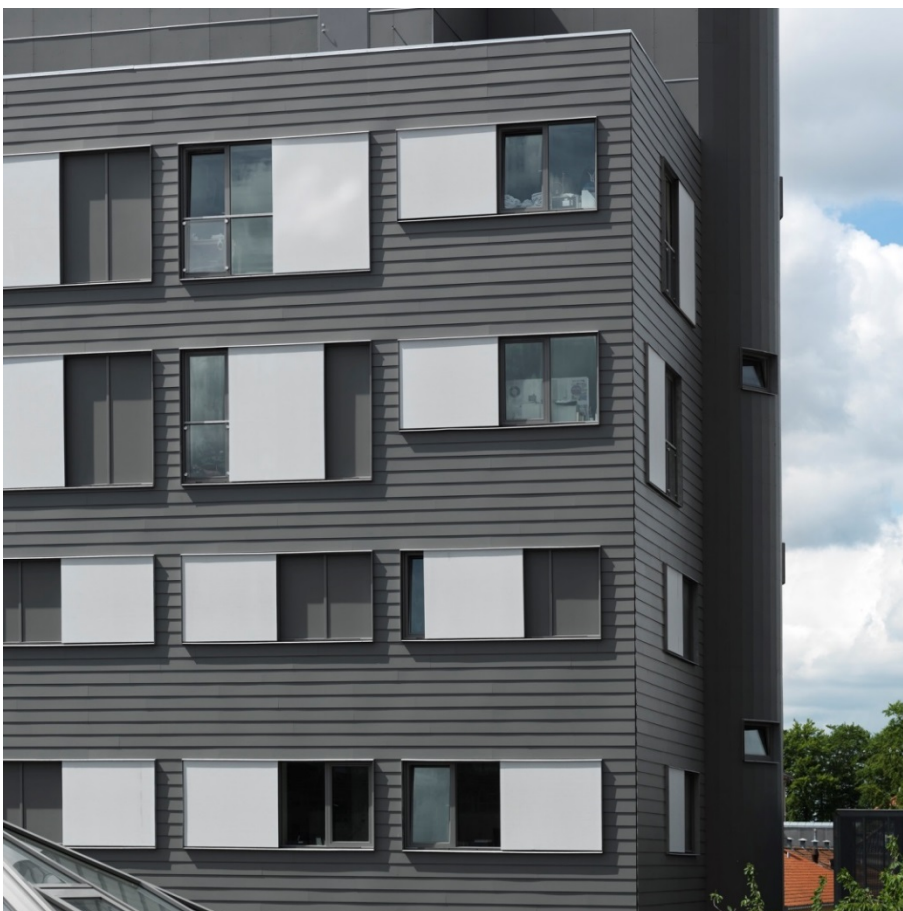
Figur 20. Afprøvnig af rammesystem med screendug på midlertidig pavillonbygning opført i forbindelse med udvidelsen af Rigshospitalet. Foto: Art Andersen.
