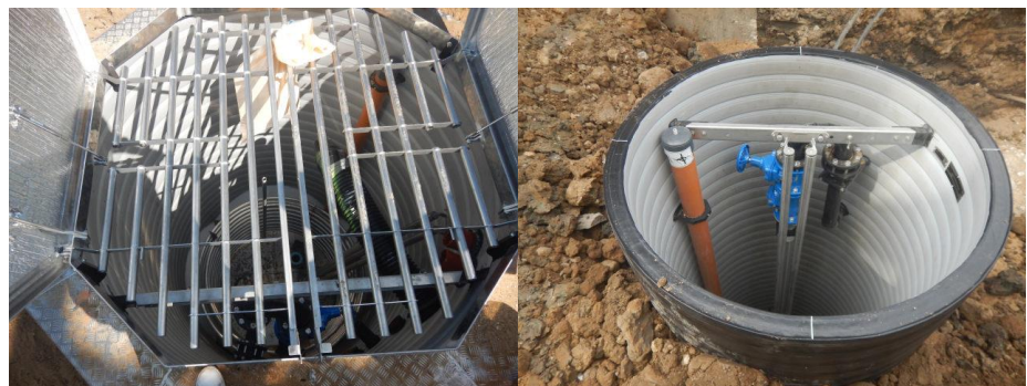
Figur 14. Varmeveksleren udført som rustfri stålspiral ses under risten til venstre og til højre ses den isolerede PE pumpebrønd, der i det aktuelle tilfælde er 6 m dyb.
