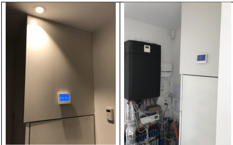
Figur 15. Teknik rum med varmeinstallation og ventilationsaggregat.
