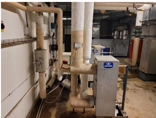
Figur 9: Hovedvarmevekslerne som ses her på billedet, gav ikke længere tilstrækkelig varme og brugte mere energi end de plejede. Dette var grundet aflejringer i vekslerne, de blev rensed og returtemperaturen er nu sænket med ca. 5-6 °C
