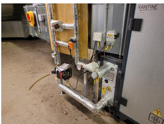
Figur 8: Dette kælder-placerede ventilationsanlæg blev undersøgt. Det viste sig, at vandmængder på den sekundær side var alt for store. Vandmængder blev indreguleret og pumpe flow blev reduceret. Hvilket resulteret i reduceret varme og elforbrug
