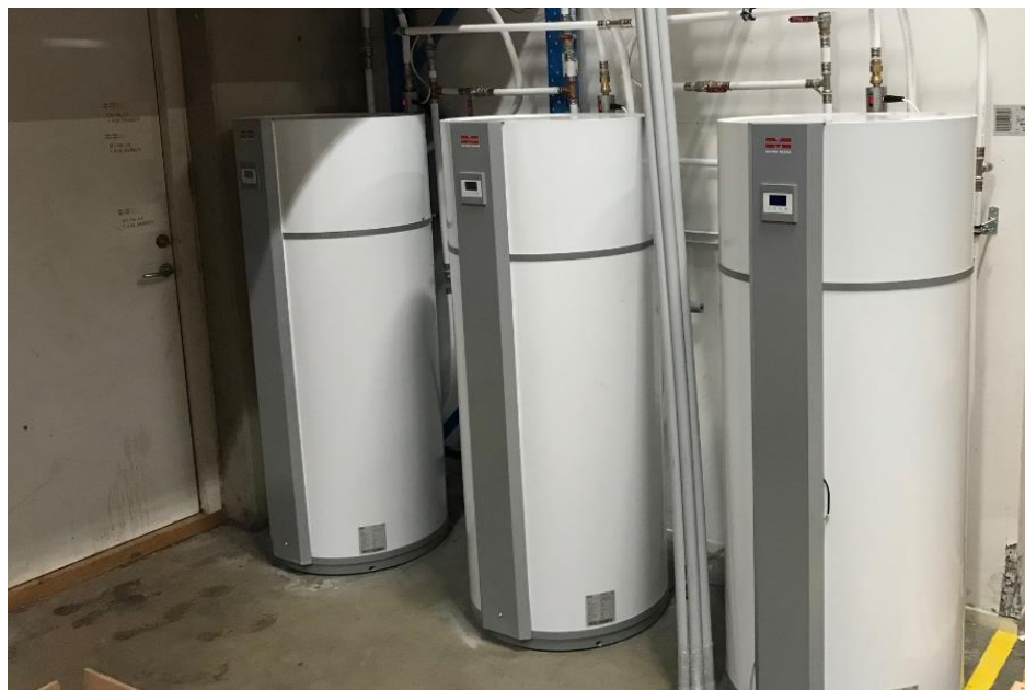
Figur 3: De 3 sammenkoblede PVT-booster varmpumpe moduler
