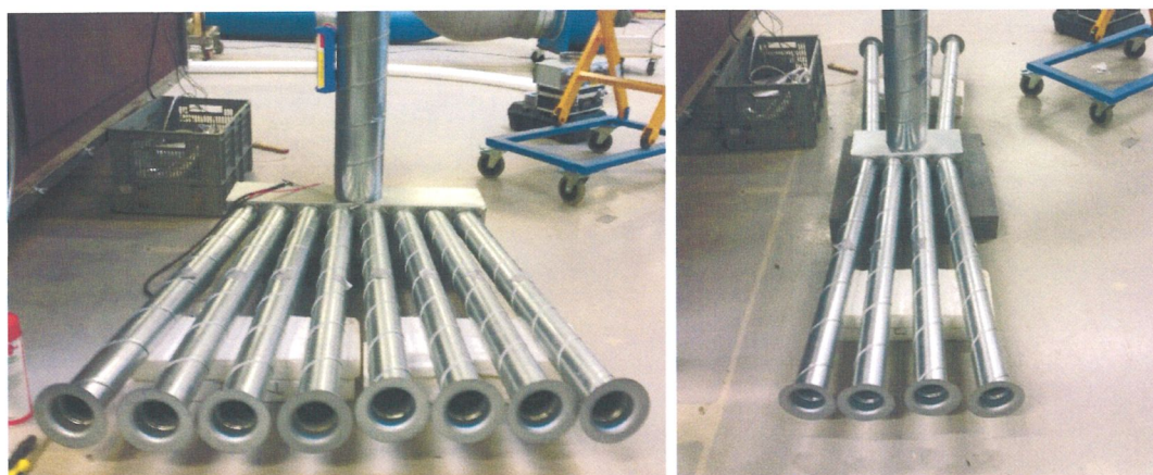
Figur 29: Manifold til udsugning. Til venstre manifold 1 x 8. Til højre manifold 2 x 4
