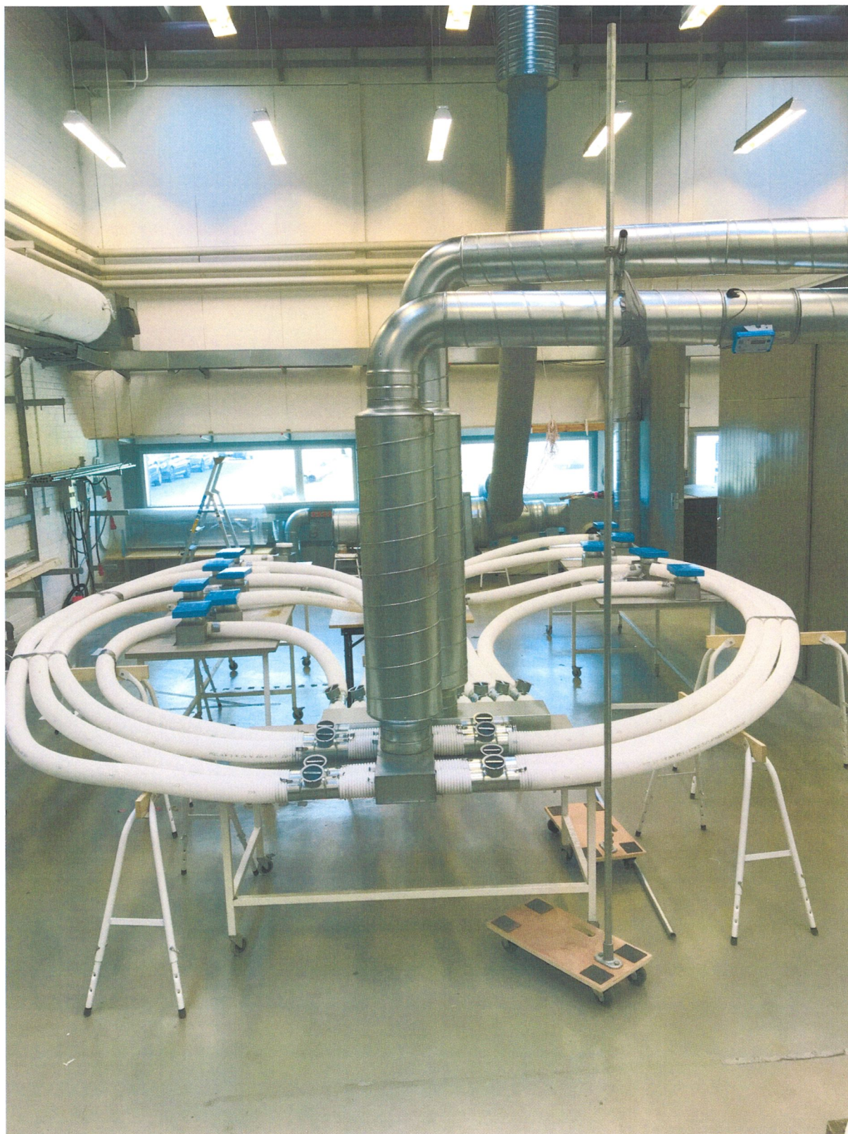
Udvalgte billeder fra laboratorietesten af det komplette ventilationsanlæg inden montage i Lind & Risør bolig
