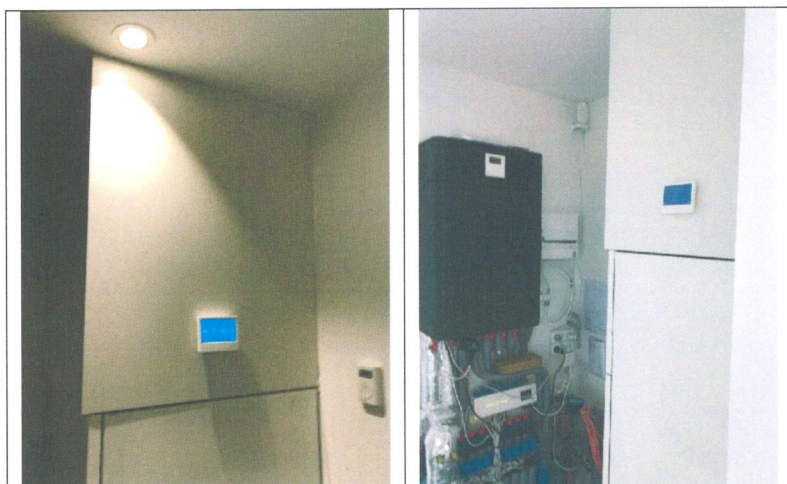
Figur 15. Teknik rum med varmeinstallation og ventilationsaggregat.
