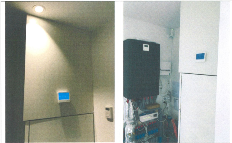
Figur 14. Teknik rum med varmeinstallation og ventilationsaggregat.
